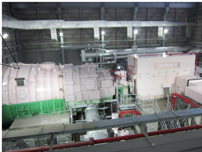
山葵沢地熱発電所蒸気タービン及び発電機
