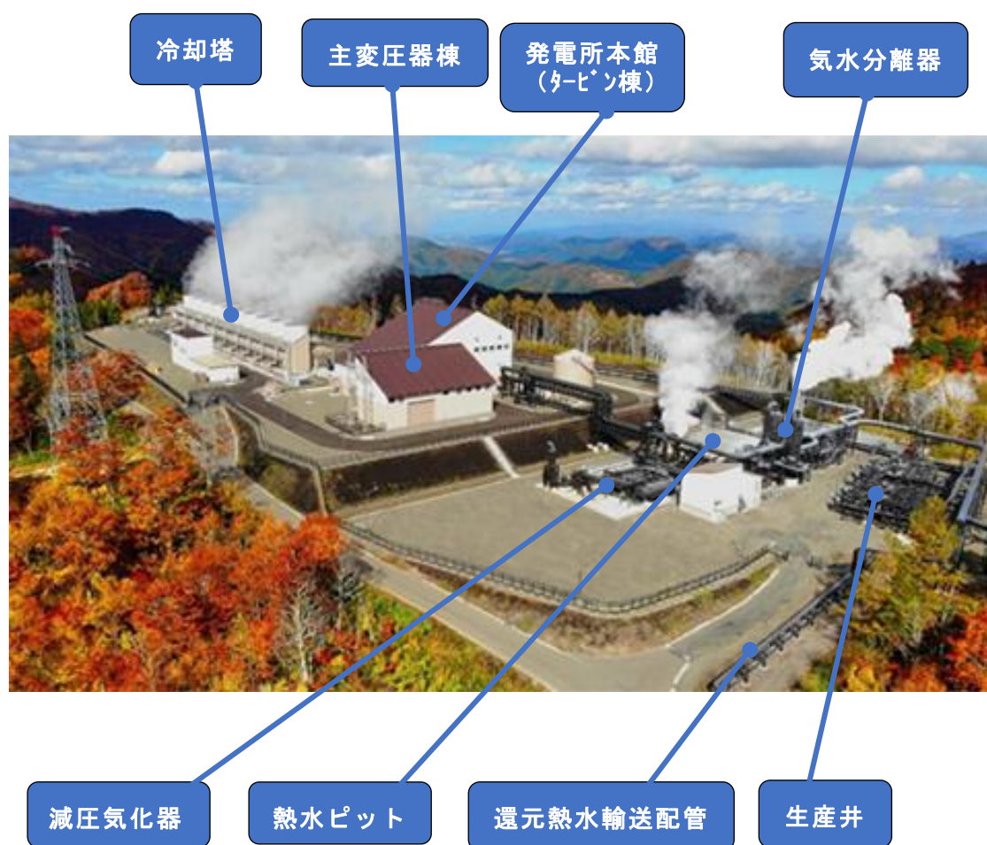
発電所の敷地内設備（提供：湯沢地熱株式会社）
